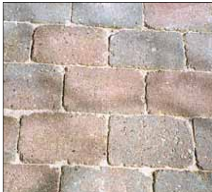
Fugerne skal efterfyldes hvis der mangler fugegrus. Der skal benyttes korrekt fugegrus.
