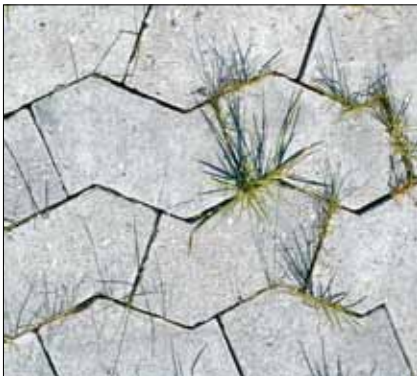
Ældre fyldte fuger har stor resistens mod ukrudt (øverst), mens nye halvtomme fuger giver gode vækstbetingelser for ukrudtet.
